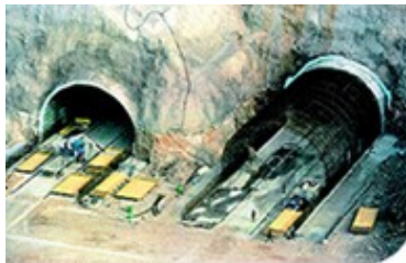
Tunnels sur le périphérique d'Athènes (Grèce)
