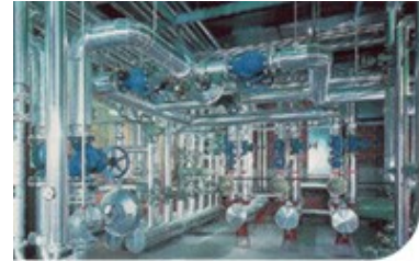
Installation de chauffage central de la cite universitaire de Lausanne (Suisse)
